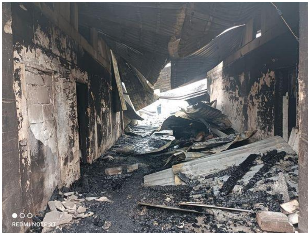
Pożar hali w miejscowości Gardno – zawałony dach
