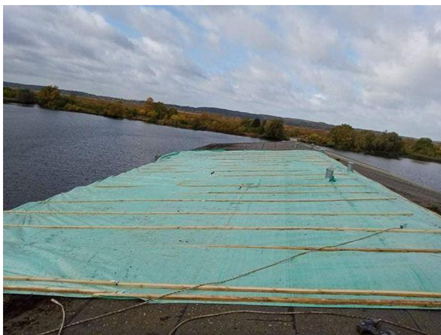
Zerwany dach przy ul. Rapackiego w Gryfinie
